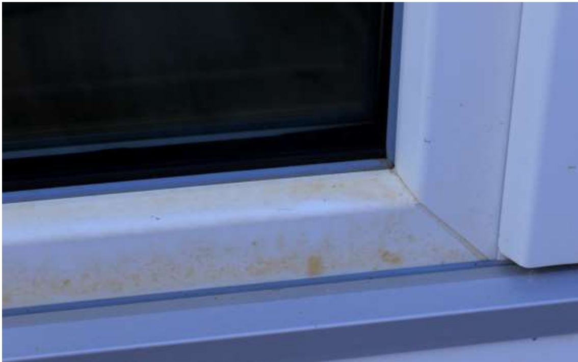
Typische Gelbverfärbung an einem unteren Flügelprofil eines Kunststoff-Fensters. Die Gelbverfärbung endet seitlich auf der Höhe der Schweißnähte. Foto: Jürgen Sieber
